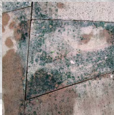
červený pískovec neošetřený
